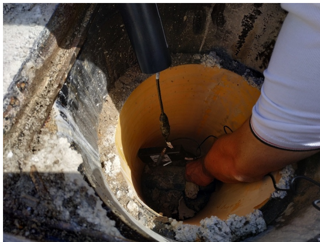
Εικόνα 8 – Εγκατάσταση αισθητήρων ΔΕΥΑΧ
