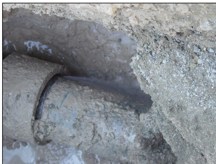
Εικόνα 4: Η απώλεια της φλάντζας σύνδεσης των αμιαντοσωλήνων
